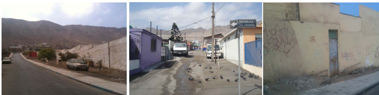
Figura N° 2-4: Ejemplo de Estado de Aceras
