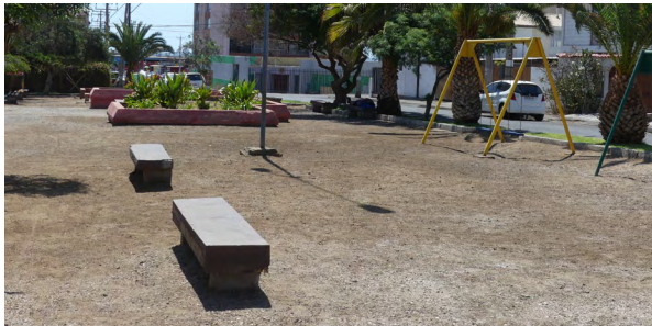
Figura 284_Banca en mal estado, ubicada en área con extrema radiación solar. [Barrio Estación]
