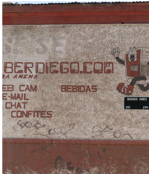
Figura 257_Mural publicitario degradado que requiere mantención. [Barrio Estación]
