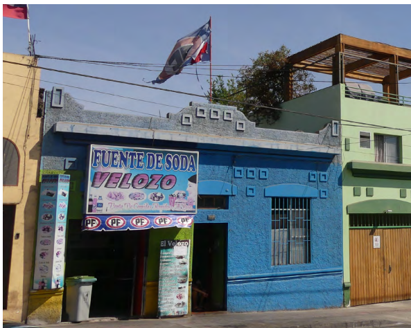
Figura 260 El letrero tiene dimensiones que opacan las principales líneas arquitectónicas de un edificio histórico. Además, los elementos entre sí no tienen coherencia estética. [Barrio Estación]
