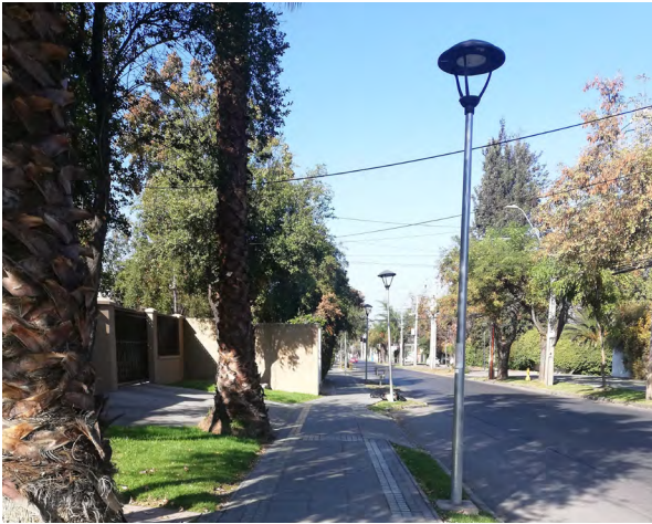
Figura 270 _Luminaria correctamente localizada, entre vereda y calzada. [Santiago, Región Metropolitana]
