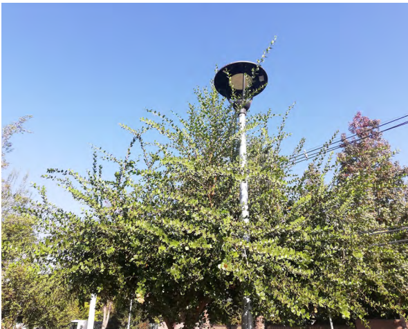
Figura 271 _Luminaria obstruida por las ramas de un árbol. [Santiago, Región Metropolitana]
