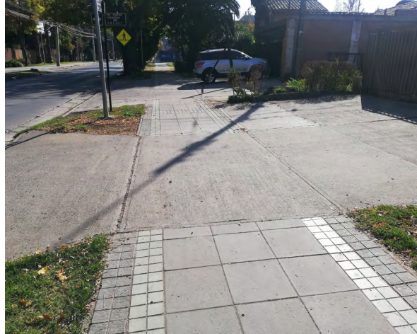
Figura 127_ Los accesos vehiculares no deben interrumpir el pavimento de la vereda. [Santiago, Región Metropolitana]
